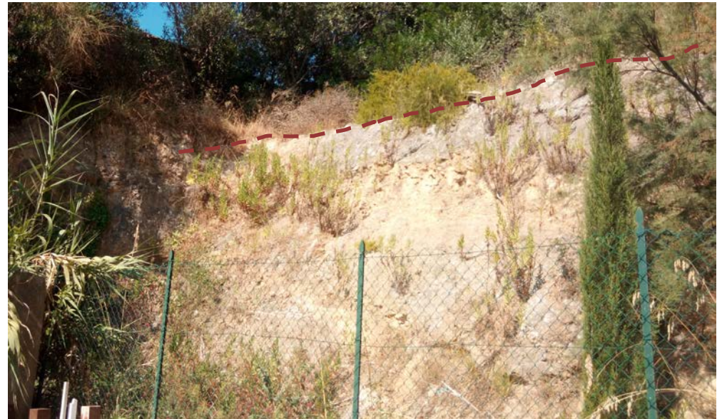
Foto 4 scarpata dietro cimitero. Visibile il calcare cavernoso e l'esiguo spessore di copertura.
